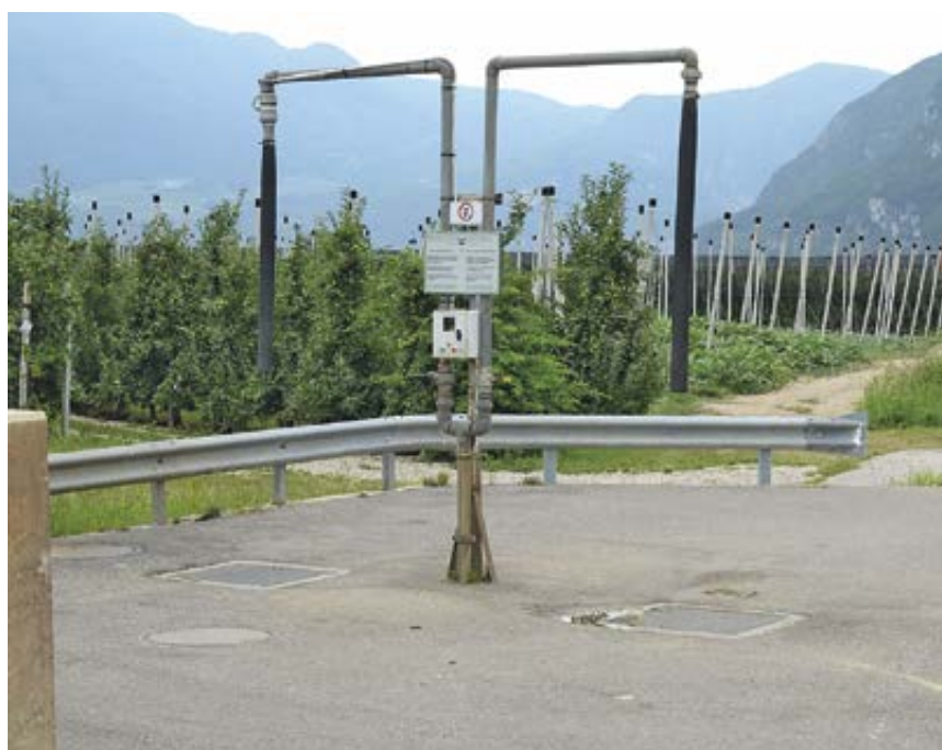
Il riempimento del serbatoio presso i punti di approvvigionamento idrico può rappresentare un rischio.
